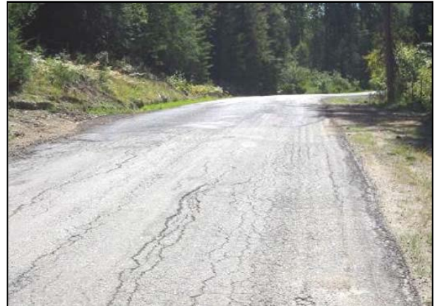
Figure 2. Exemple de chaussée ayant des problèmes de fondation. (Photo gracieusement fournie par Portland Cement Association (PCA)).
